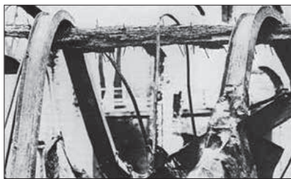
Fot. 3 | Zdjęcie obiektu po pożarze, widoczne uplastycznione elementy stalowe wiszące nadal przenoszącymi obciążenia elementami drewnianymi
