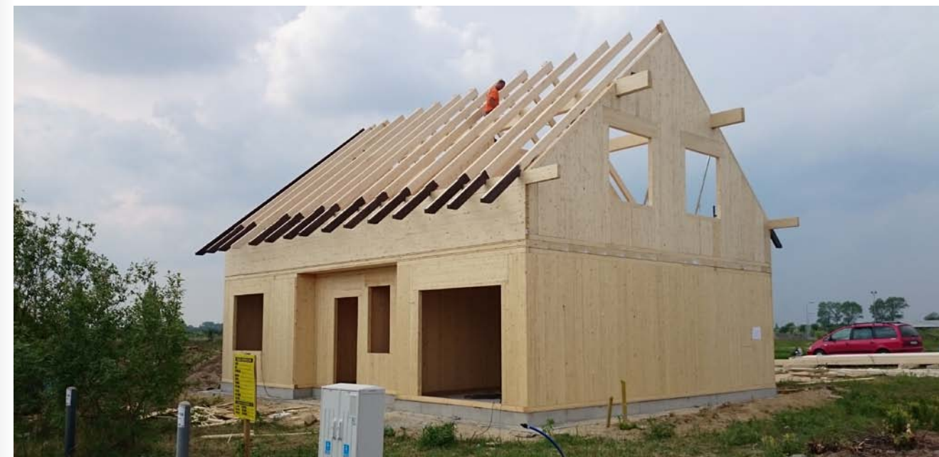
Fot. 3. Kompletna konstrukcja domu w systemie HBE przed przystąpieniem do montażu izolacji.
